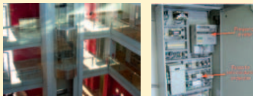
Frequenzumrichter für 3-Phasen-Wechselstrommotor (Aufzug)
